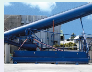
骨材回収・排水処理設備 K&Kプラント製 ●4台同時洗車 ●中和装置
